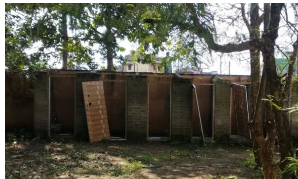
(d) Dilapidated condition of toilets
